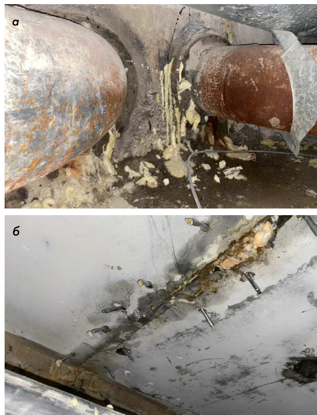
Рис. 3. Водопроявления на выпусках инженерной коммуникации (а) и в технологическом шве (б), уплотненных однокомпонентным гидроактивным пенополиуретановым инъекционным составом
